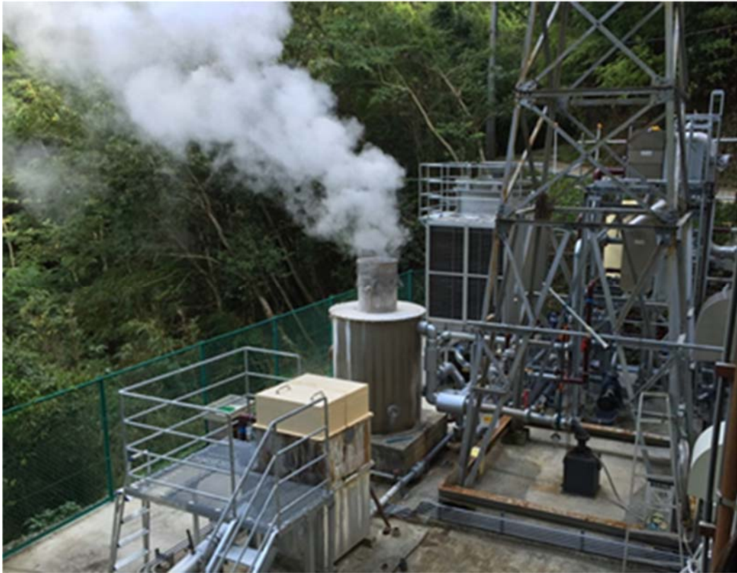
図3 バイナリー発電、商用1号機全景[6]
