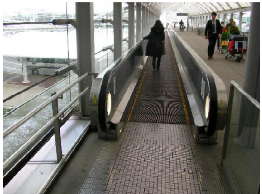
成田空港動く歩道
