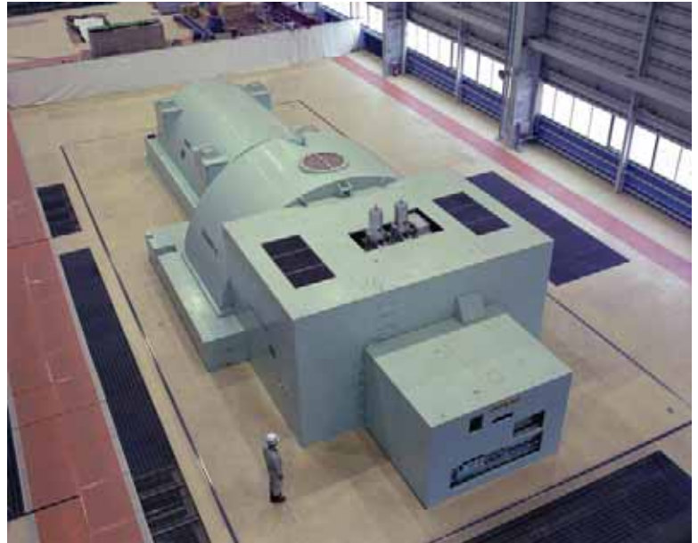
写真39 沖縄電力金武1号220MWタービン [提供] (株)日立製作所
