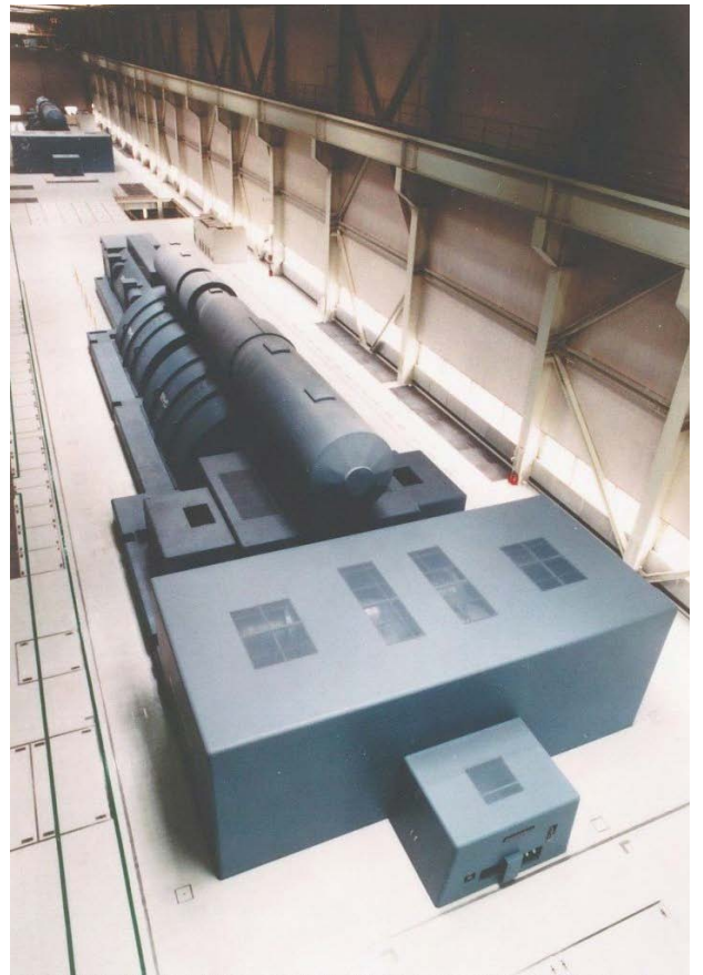
写真26 中部電力川越1,2号700MWタービン [提供] (株)東芝
