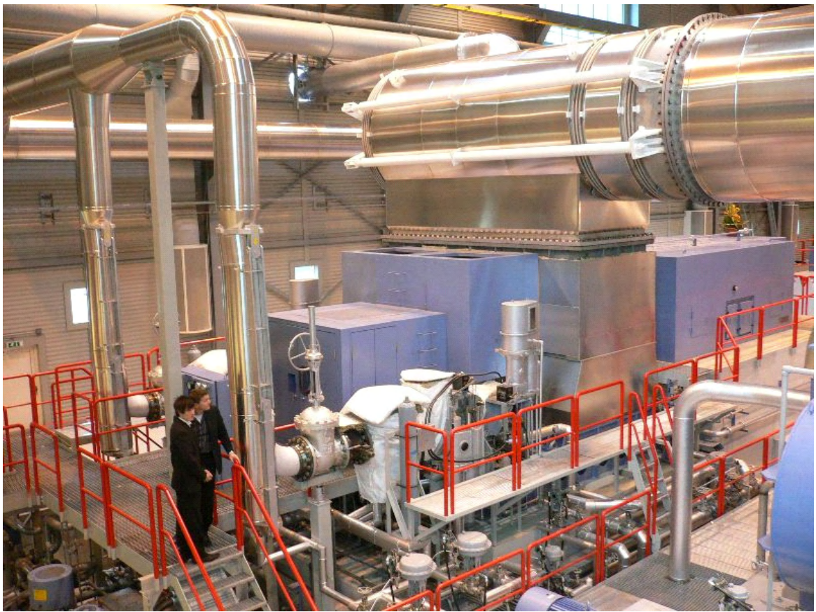
写真 12 Nesjavellir 発電所 30MW タービン [提供] 三菱重工業(株)長崎造船所
