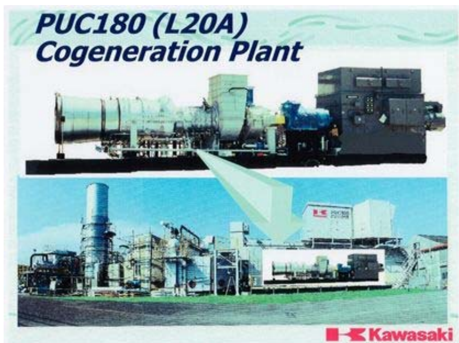
図13 明石工場内のL20Aを用いたコージェネレーション発電所
