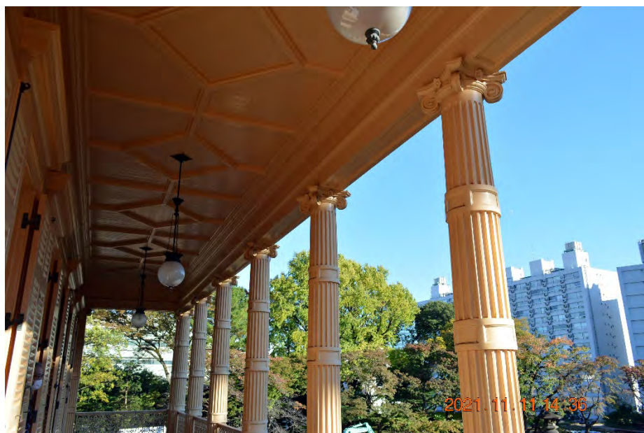
「深秋の旧岩崎邸2階ベランダのイオニア式列柱と冷房室外機が蝟集する公団住宅」中村 定さん（S44/1969卒）
